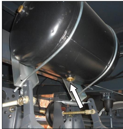
Rys. 43 – Położenie zaworu odwadniającego w zbiorniku.
